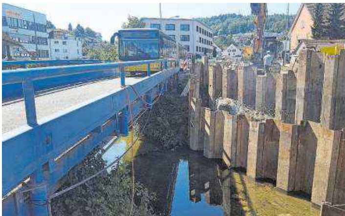
Bis im Herbst wird der Verkehr über eine Hilfsbrücke (l.) geführt. Bild: sga
