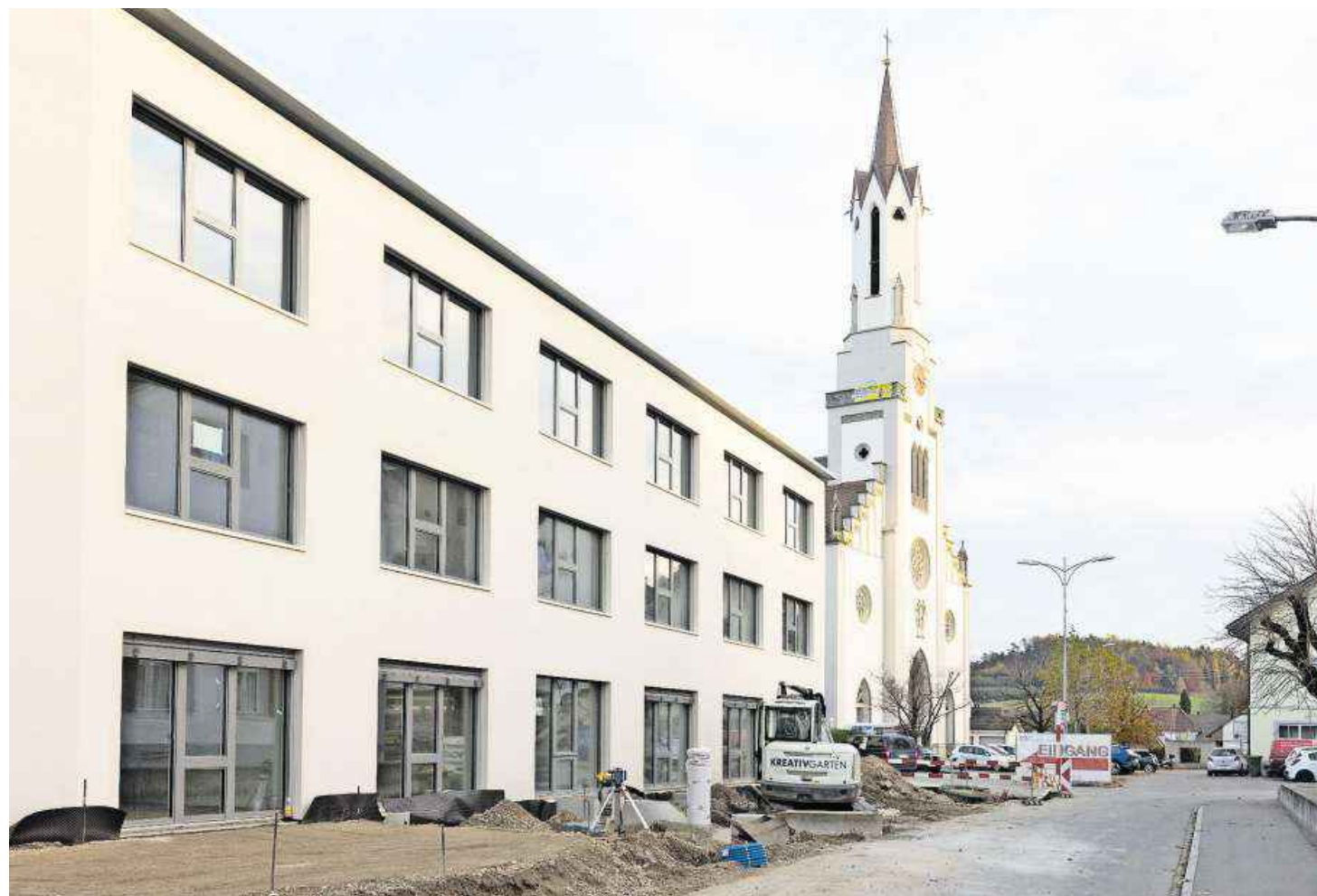
Wo früher das Personalhaus und der Werkhof standen, ist innerhalb eines Jahres das neue Pflegeheim entstanden.
