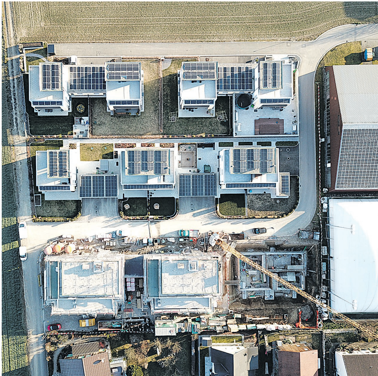
Die aktuelle Drohnenaufnahme zeigt die zwei Zeilen mit den fertiggestellten Einfamilienhäusern und die dritte mit den im Bau befindlichen Mehrfamilienhäusern. Das Solarfeld rechts im Bild befindet sich auf der Tennishalle.
